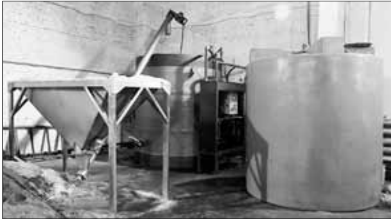
■ Установка для приготовления солевого раствора
